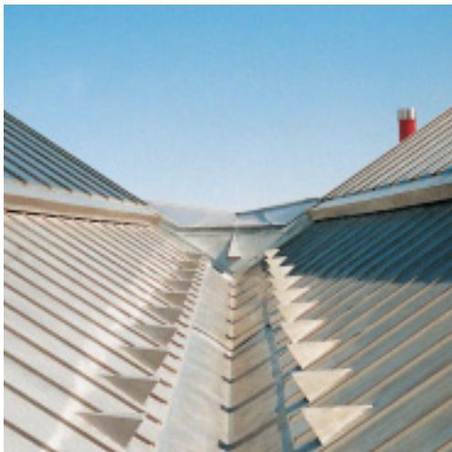
Ventilatiekappen in de geul van de dakgoten zorgen voor ventilatie van de dakstructuur.
